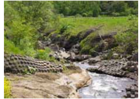
川底が削られた河川 (拡幅による流速低下策や河床安定のための工作物設置を計画)
