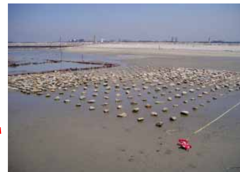
礫浜完成状況:角礫や玉石の設置、配置時の密度を変化させた礫浜をつくり、地形変動、環境調査を実施します。その奥には、土壌で囲われた領域に造成した混合土エリアもあります。(東洋建設)
