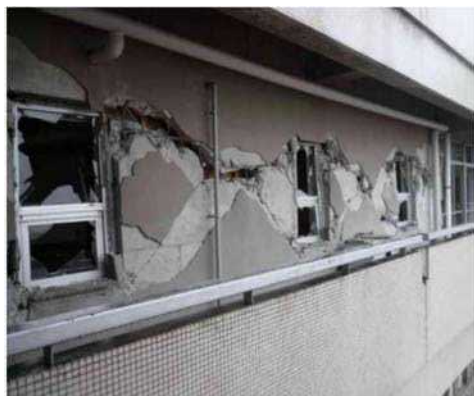
地震により機能を喪失した庁舎
