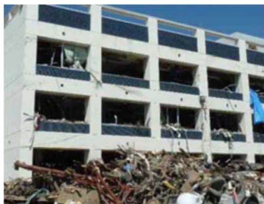
津波により機能を喪失した庁舎
