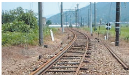
線路の変状、レール損傷、道床不良等
