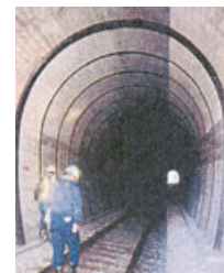
トンネルの変状、クラック、漏水等
