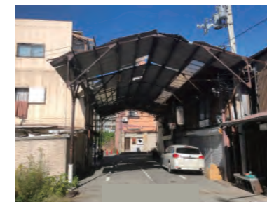
老朽化した卸売市場の庇
