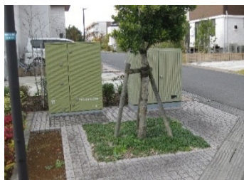
道路用地内の緑地に 設置した地上機器
