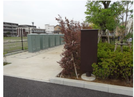
公園への地上機器の集約配置 利用者に影響がないよう設置を工夫
