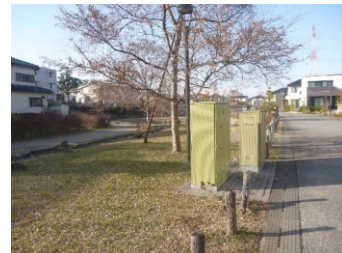
公園用地内に設置した 地上機器
