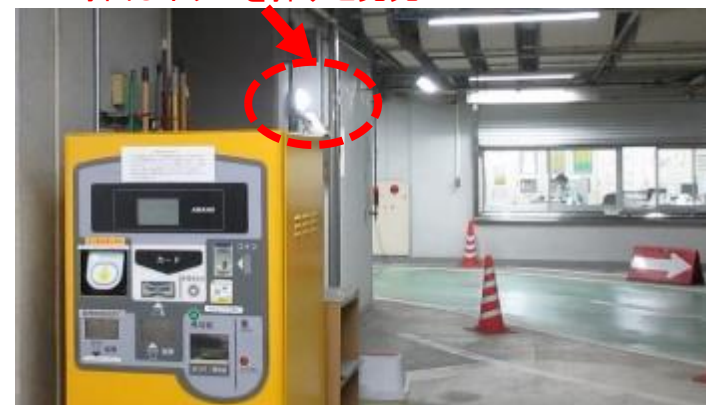
＜発光により、呼出し機能の作動を知らせる装置＞ 95 (名古屋市提供資料)
