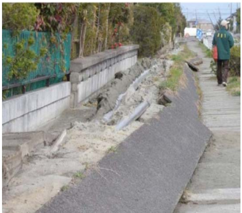
埋設管の浮上がり／茨城県潮来市
