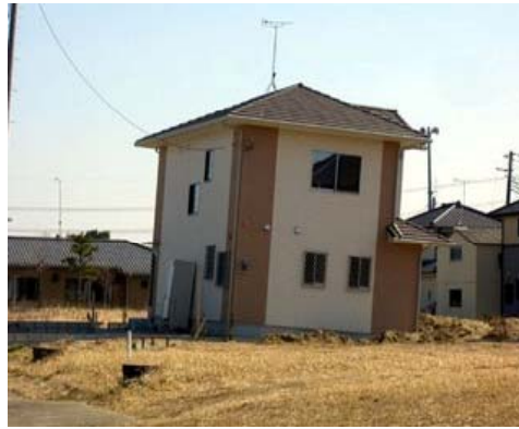
建物の傾斜被害／茨城県神栖市
