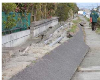
埋設物の浮上がり／茨城県潮来市
