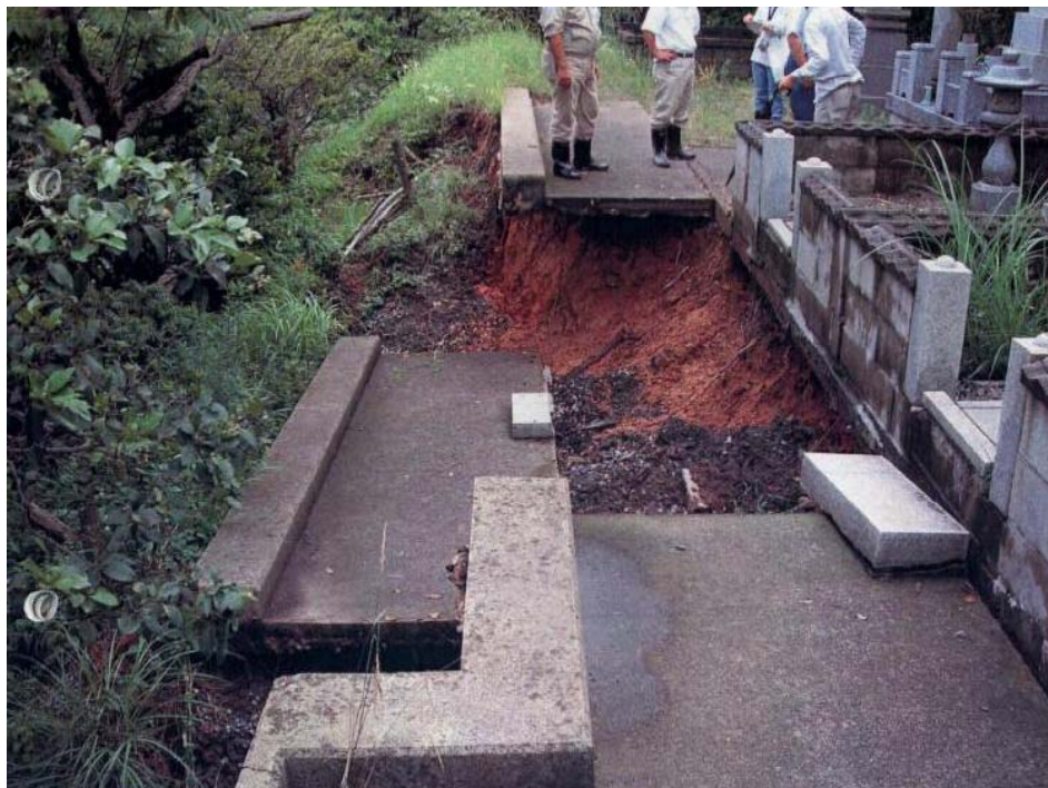
降雨による園路の被災
