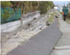
宅地の液状化被害
