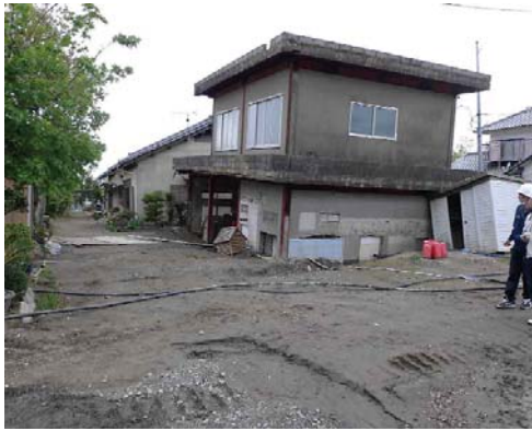
建物の傾斜被害と噴砂／茨城県稲敷市
