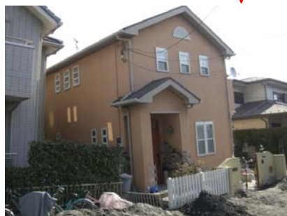
宅地の傾斜被害と噴砂／千葉県浦安市
