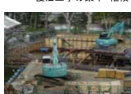
施工ヤードの不足
