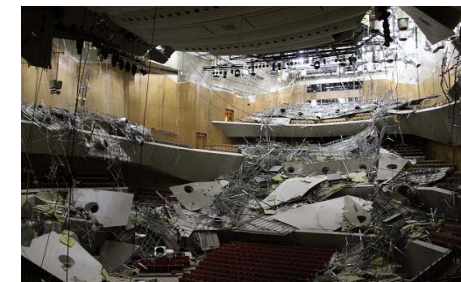
【音楽ホールにおける天井等の脱落】
