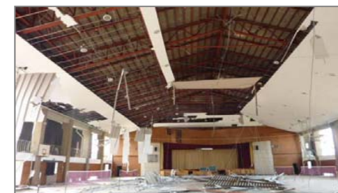
【体育館における天井等の脱落】
