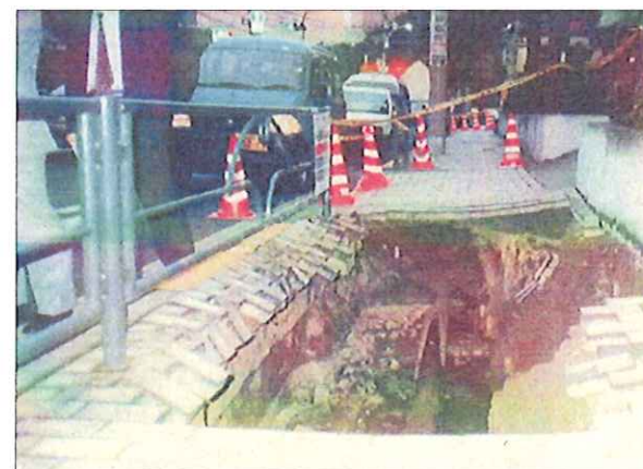
道路陥没による事故
