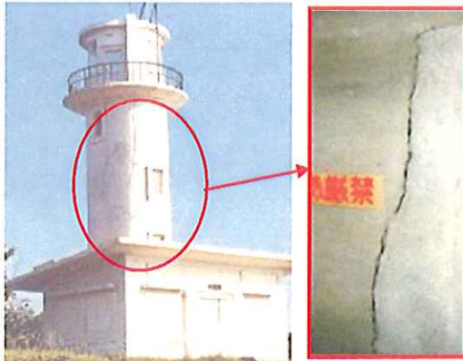
永年の風雨による亀裂
