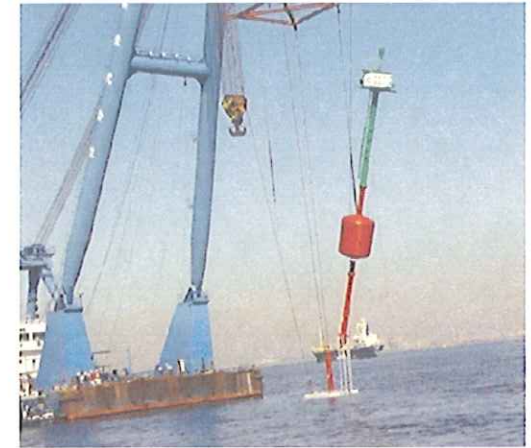
視認性に優れた灯標の設置
