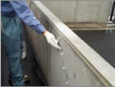
ひび割れ補修工法の例 ひび割れ部の表面の汚れ、付着物等を除去し、エポキシ樹脂を低圧で注入
