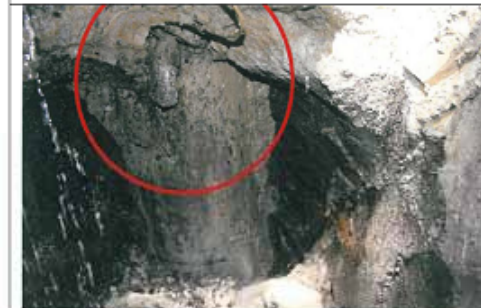
杭の損傷 (No. 2)
