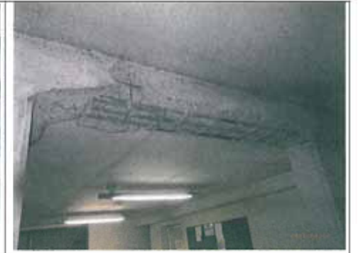
梁かぶりコンクリートの脱落
