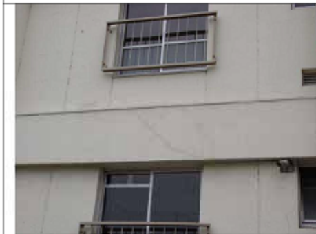
梁に生じたひび割れ
