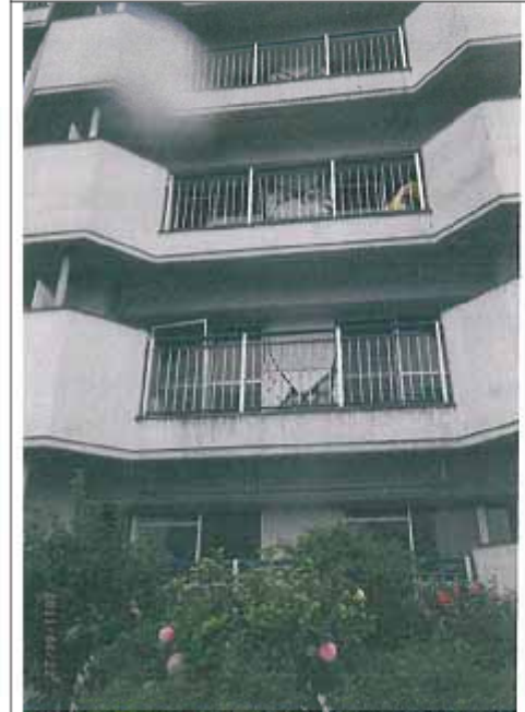
バルコニー側方立壁の損傷
