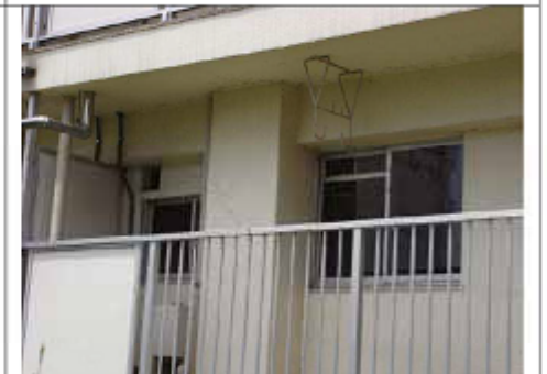
柱に生じたひび割れ
