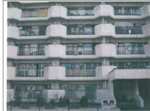
バルコニー側方立壁の損傷
