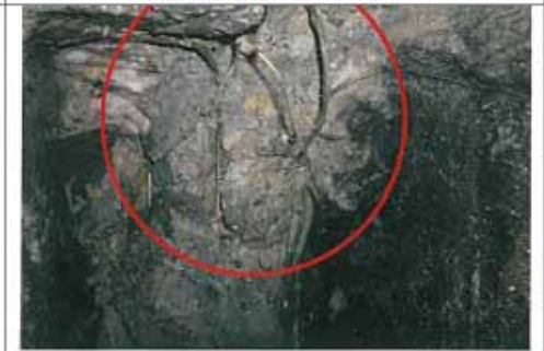
杭の損傷 (No. 1)
