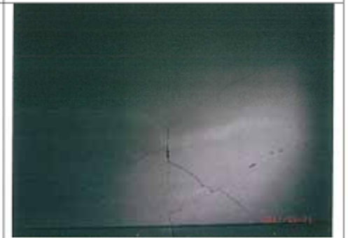
耐力壁に生じたひび割れ
