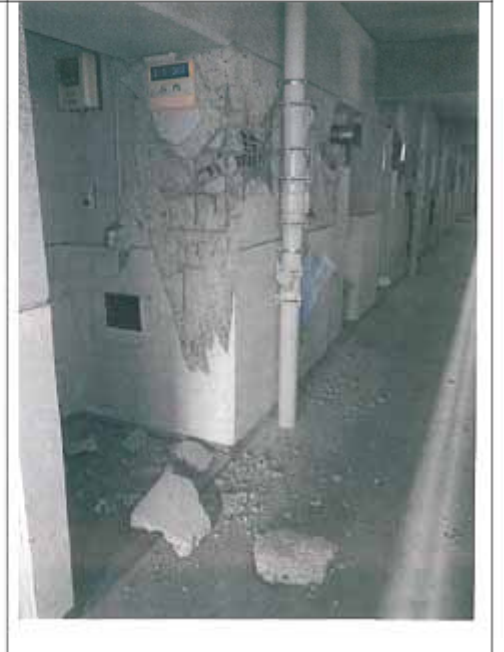
共用廊下側二次壁の損傷
