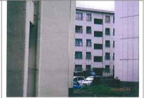
建物の傾斜状況
