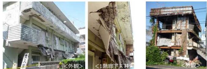
2階の廊下部分が崩落した事例 <外観> <1階廊下天井> 外壁が崩壊等した事例 <外観>
