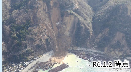
写真③ 国道249号法面崩落
