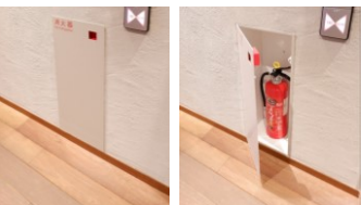
廊下上の壁埋込型消火器ボックス
