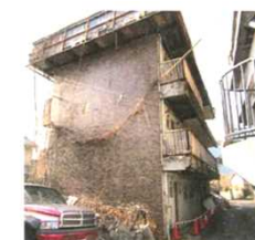
外壁剥落が発生
