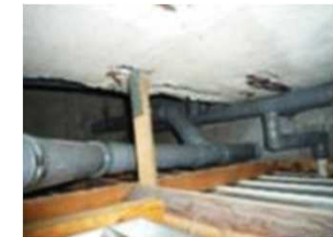
配管が腐食し漏水が発生
