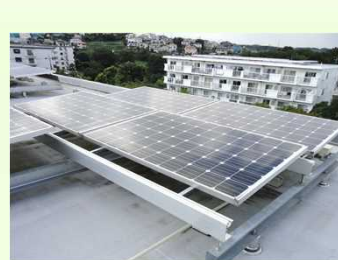
太陽光発電関連設備の設置
