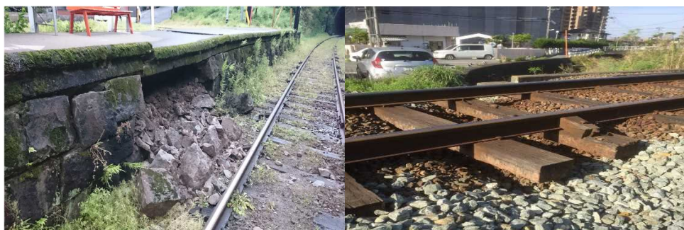
（池田駅のホームの石積み倒壊状況）
