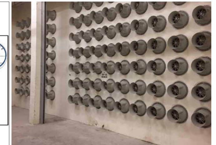
ベドックノース駅の防爆設計が施された壁／ Blast valves in wall at Bedok North Station
