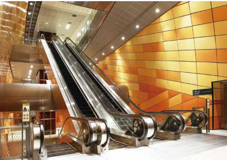
ベンクーレン駅、地下6階までをつなぐエスカレーター／ Bencoolen Station, escalators leading to basement 6 level
