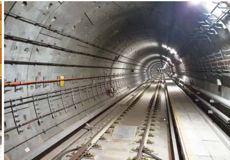
高度な管理ノウハウにより掘進されたシールドトンネル／ Tunnels bored by TBMs with advanced management knowhow
