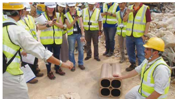
シンガポール チャンギ国際空港 施工前デモンストレーション/ Pre-installation demonstration at Singapore Changi International Airport
