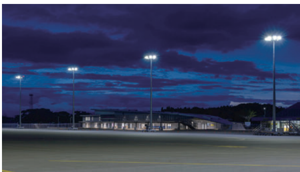
メンテナンスを容易にするためにLEDを採用し、電動昇降式としたエプロン照明
