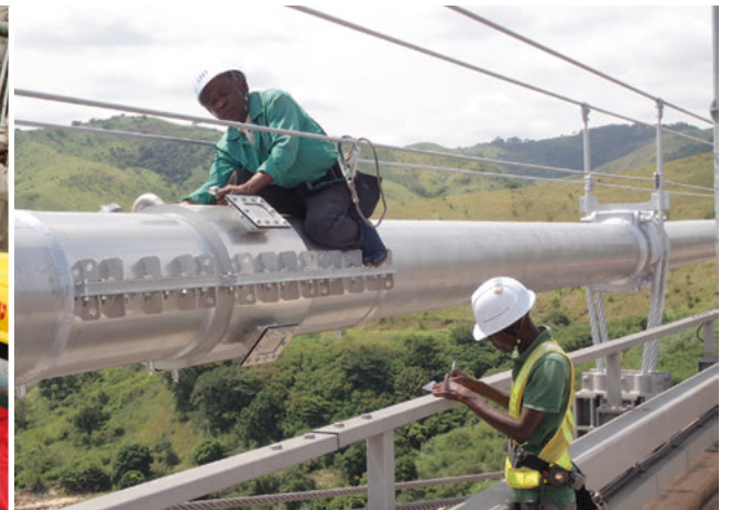
中央部の排気ユニットでの湿度計測状況
