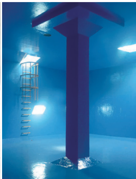
配水池内部 日本から調達したエポキシ樹脂塗料により内面防食を施した
