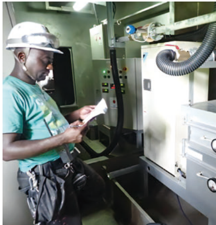
主塔内に設置されたケーブル送気乾燥システム
