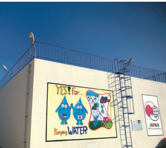
配水池全景 自然流下方式に伴い2池の配水池が建設され、その内高台に建設したRC造の配水池900m 3 、壁には近隣小学校より募集した節水に関するポスターを描画
