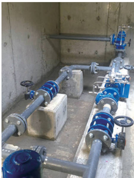
減圧弁室 自然流下方式への変更に伴い、地域毎に適切な圧力にするため設置された減圧弁室
