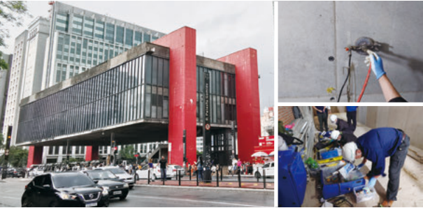
ブラジルRACIONAL社が受注したサンパウロ美術館別館新築工事において発現した内壁のひび割れを補修
