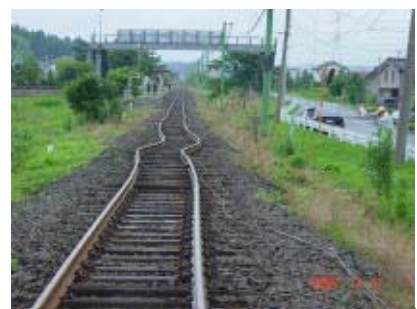
荒浜駅付近のレールの変状
