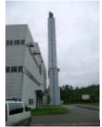
損傷した鉄筋コンクリート
