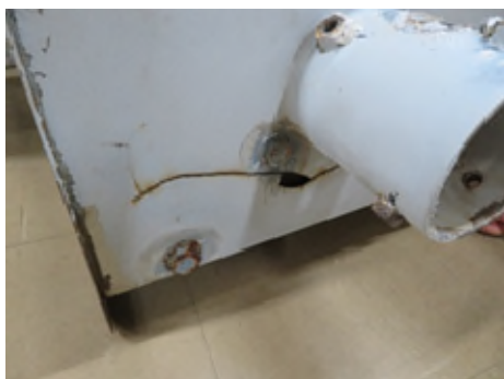
写真-2 老朽化した灯具筐体
