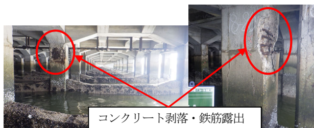
写真-2 脚柱部老朽化状況
