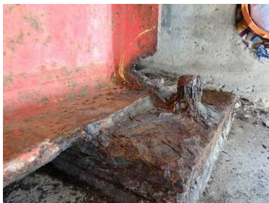
写真-3 支承部の損傷写真
