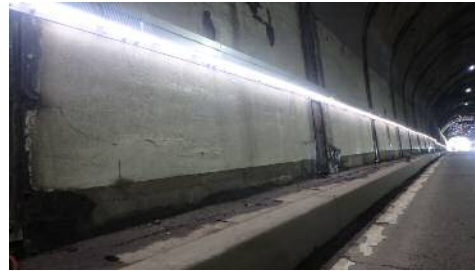
(写真-13 下り線側の設置状況)
