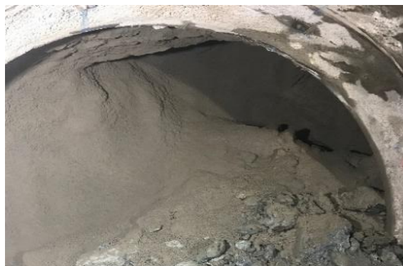
写真-2 天端の抜け落ち
