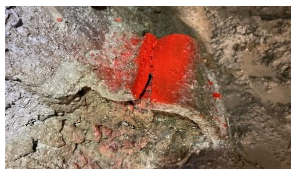
写真-9 鋼製支保工の変形
