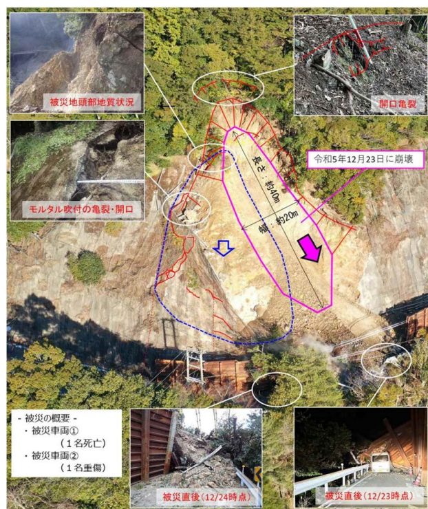
図-2 2023年12月 被災箇所の状況
