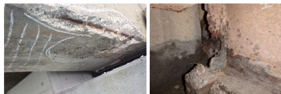
図-2 伸縮装置からの漏水による主桁端部の損傷事例
