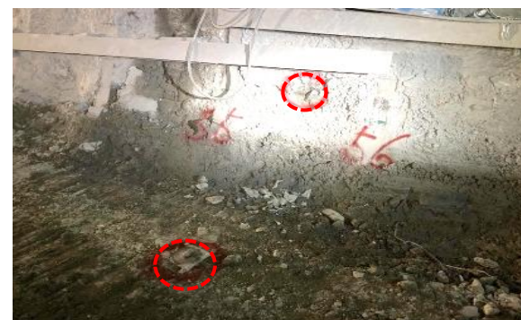
写真-8 ロックボルトの破断
