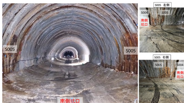
写真-2 インバート変状発生状況(S005～S006)
