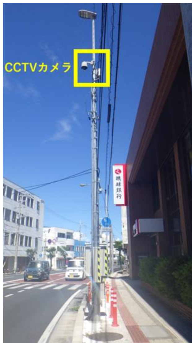
写真―2 与那原交差点CCTVカメラ
