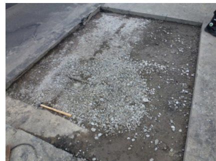
写真-1 床版上面に発生する土砂化
