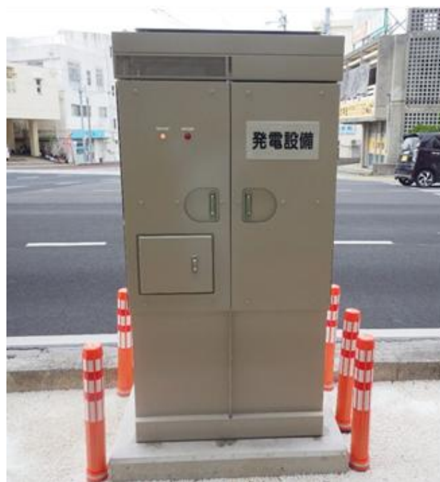
写真―3 168時間以上運転可能な発電装置
