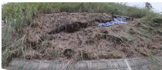
図-3 ヨシススキが繁茂する法面に発生した変状
