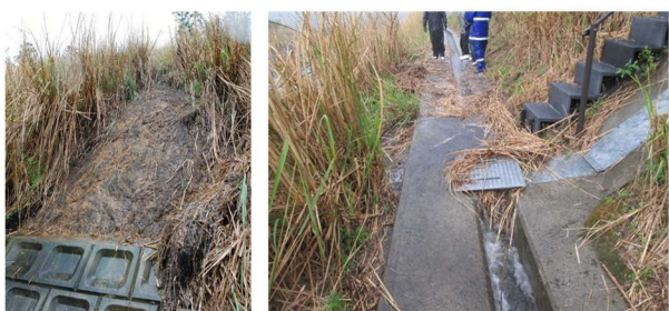
図-4 ヨシススキが繁茂する法面に発生した表層崩壊とヨシススキによる排水溝の閉塞状況
