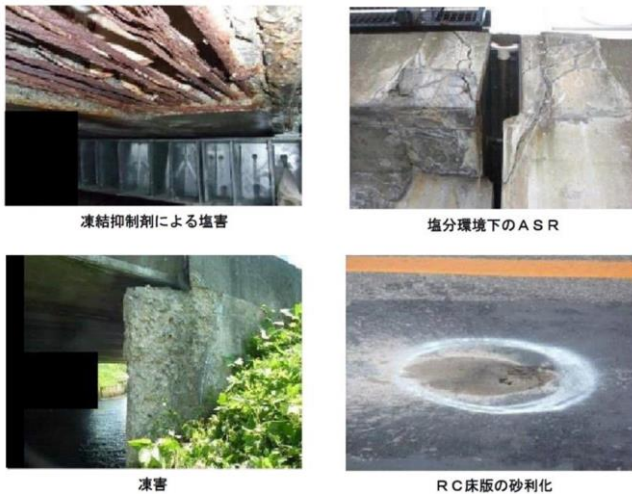
写真-1 劣化の例
