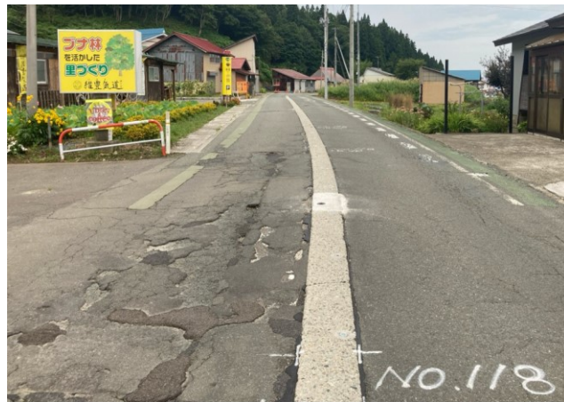
写真－2 舗装劣化状況
