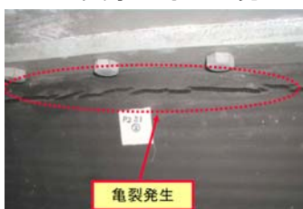
主に上下端の鋼板端部で発生 出典：土木学会-支承の種類・点検・損傷事例集
