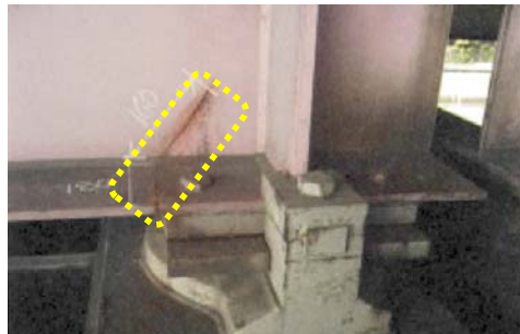
ソールプレート付近からの疲労亀裂 出典：道路橋支承部の改善と維持管理技術
