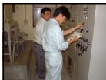
非常電源の立ち上げ状況
