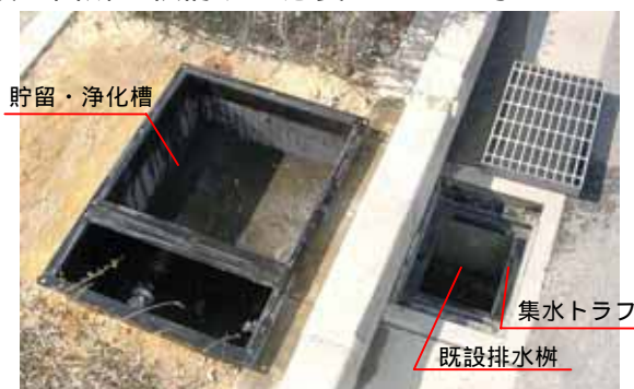
図3-7 側溝型パイロット装置(設置場所: 滋賀県栗東市霊仙寺 主要地方道栗東志那中線)
