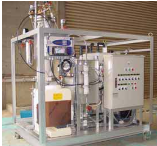
写真-1 膜モジュールを用いた排水処理システム
