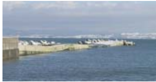
写真 - 1 D防砂堤の被災状況
