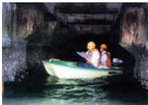
写真 - 1 栈橋下劣化状況のスケッチ
