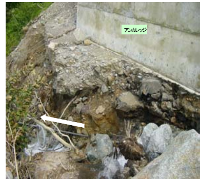
写真－4 アンカレッジ前面の洗掘状況
