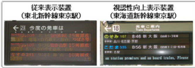
写真-5 東京駅新幹線ホーム時刻表示装置
