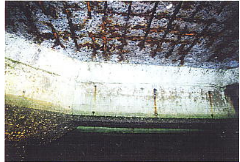
写真 鉄筋が露出した栈橋上部工
