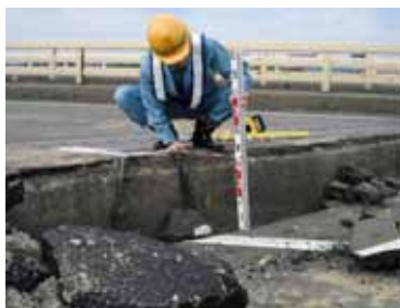
写真 - 1 取付盛土と橋梁部の段差
