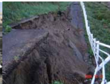
写真 - 2 のり面の崩壊状況
