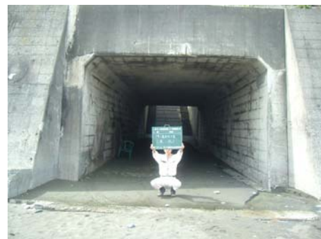
写真-1 人道用カルバートボックス
