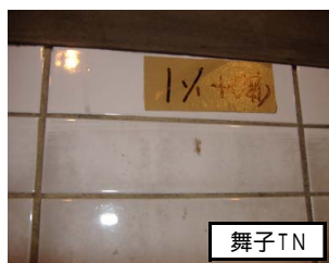
写真-6 改良前の清掃面
