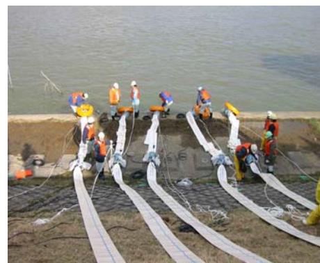
写真5 直列接続状況
