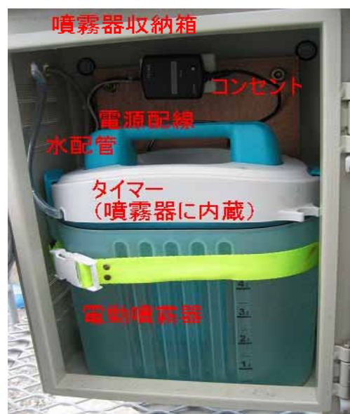
写真 - 9 噴霧器収納箱内部 雨水
