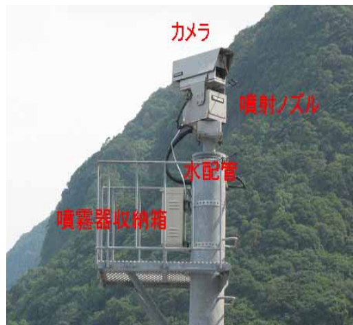
写真 - 7 CCTVカメラ部
