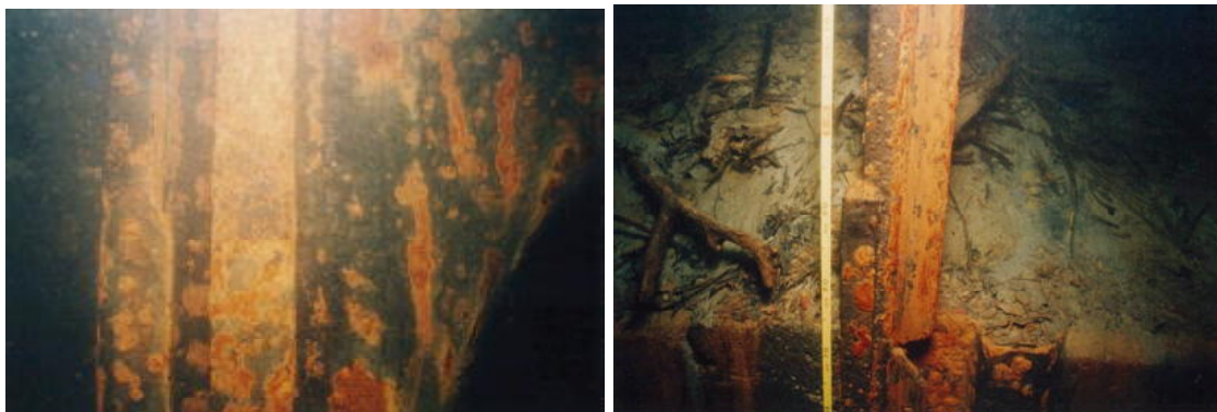
写真1．戸当り腐食状況
