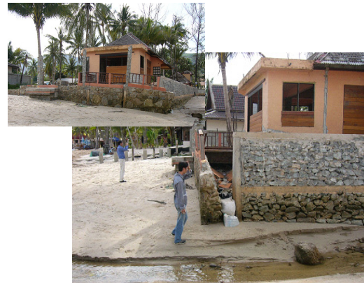
写真-6 基礎地盤の洗掘
