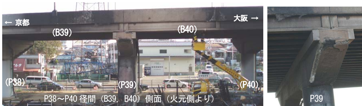
写真-2.1 被災状況全景(鎮火直後)
