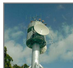
写真7 鶴田局パラボラアンテナ
