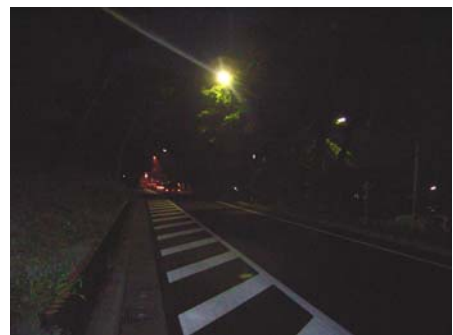
写真-2 既設照明の点灯状況
