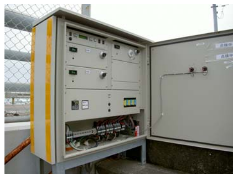
写真-3 外部電源装置
