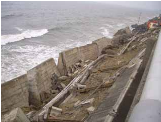
写真-1 擁壁崩落状況
