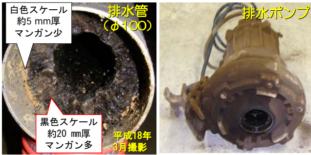
写真-1 排水管と排水ポンプのスケール付着状況
