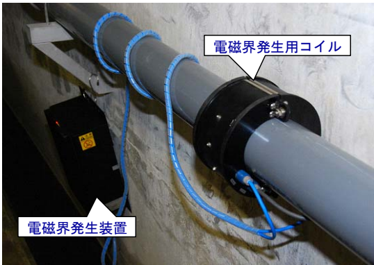
写真-3 電磁化水発生装置設置状況
